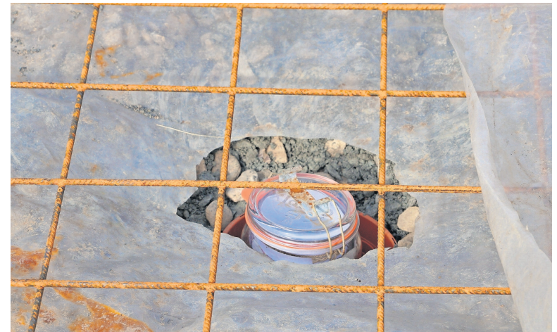
In einem kleinen Loch im Fundament ließ Bürgermeister Helmut Dietz die Zeitkapsel ein. Das Einmachglas mit Hinweisen auf die Geschichte der Kapelle wird eingeschlossen in Zement eine lange Zeit überdauern.
